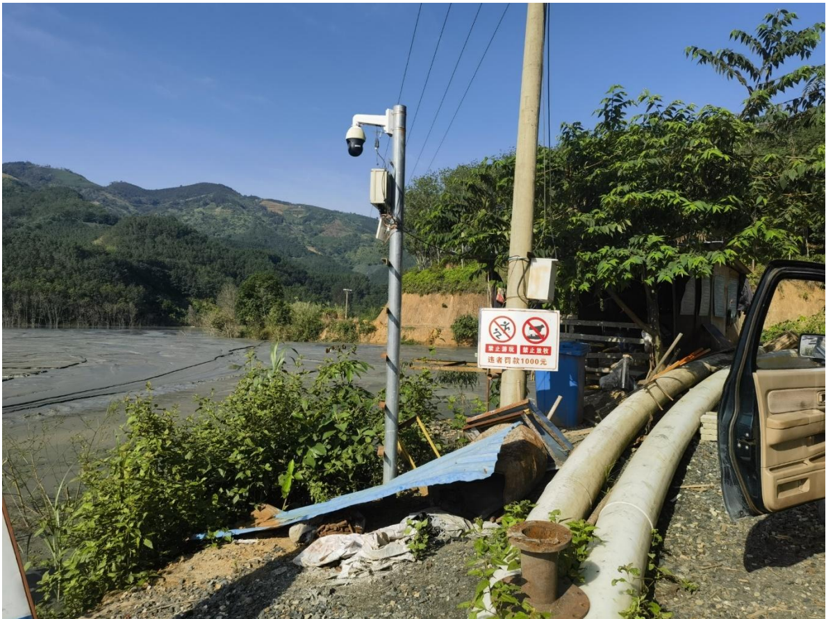
图 2-24 库区滩面视频监控摄像头
