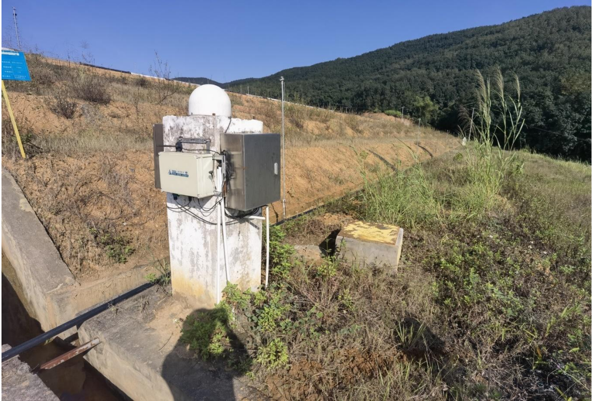
图 2-23 堆积子坝在线位移监测设施及人工浸润线监测点
