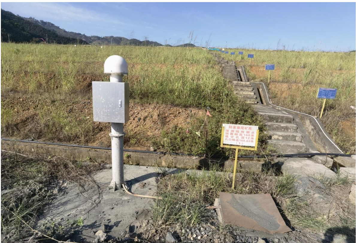
图 2-21 初期坝在线位移及浸润线监测设施
