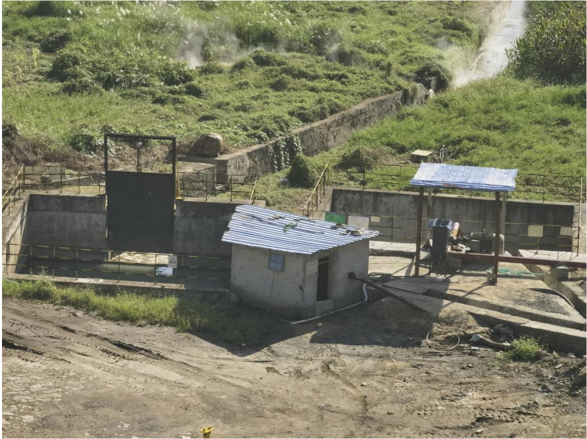
图 2-16 坝前调节池及泵站
