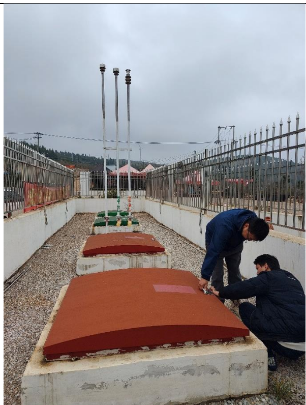
图 2-17 储罐区及通气管
