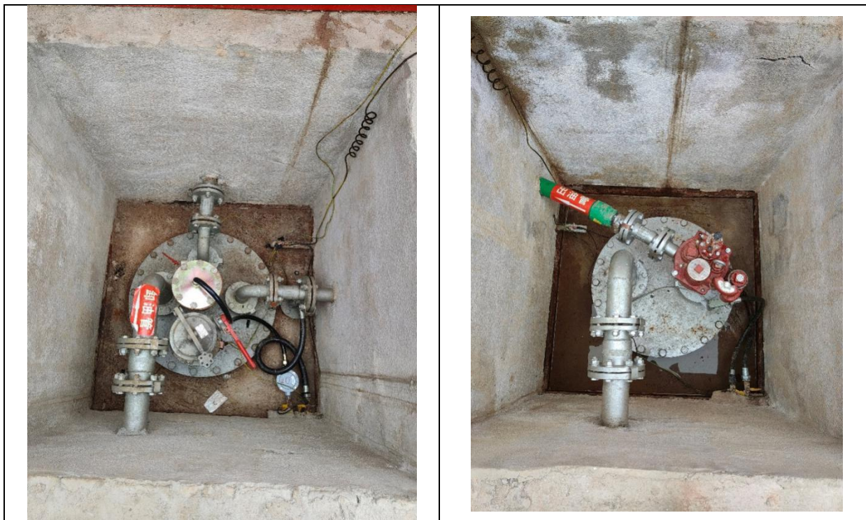
图 2-19、图 2-20 油罐人孔操作井
