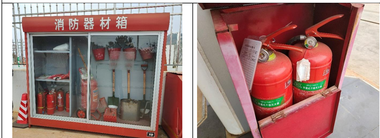
图 2-21、图 2-22 加油站消防器材
